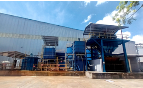
#1, #2RO 농축수 유량계 설치 및 일일 적산량(세아씨엠)
