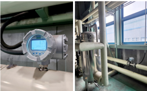
폐수처리설비(SeAH Steel Vina)
